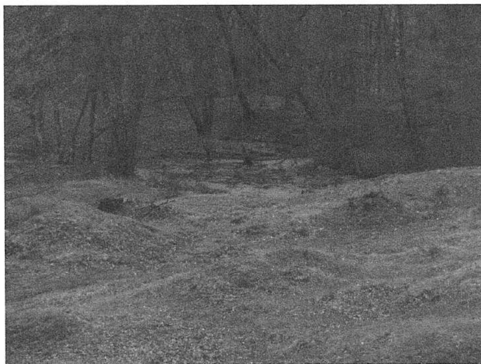
Fig. 2 Zonă cu alunecări, la ieșirea de est a tunelului Sălătruc – Poiana, pe marne de Pucioasa
