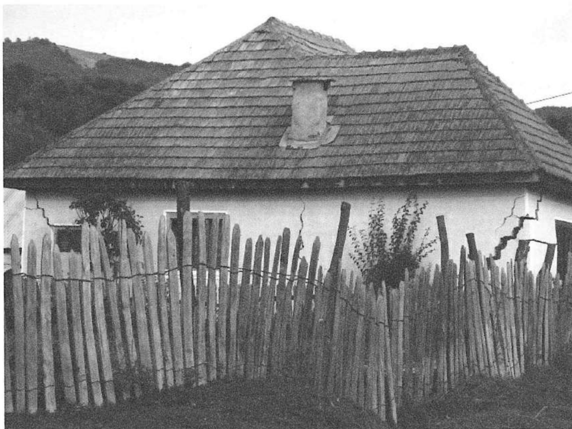
Casă afectată de alunecări de teren pe DN 7D (satul Spinu)
