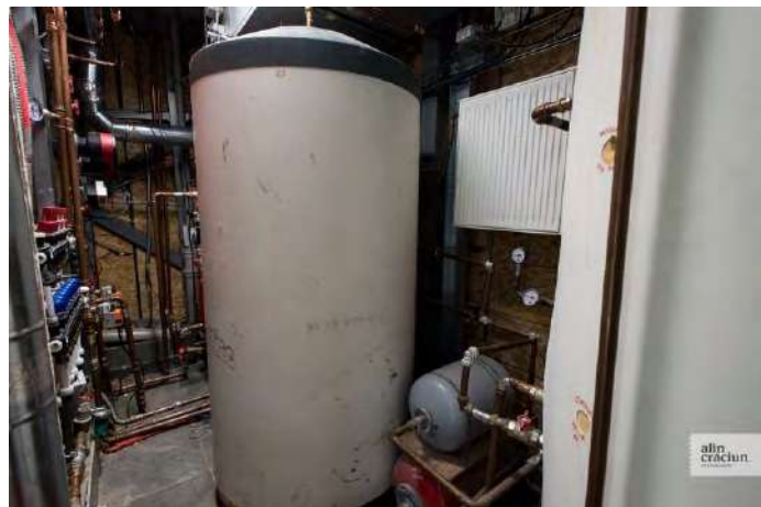
Camera tehnică a a instalațiilor mecanice
