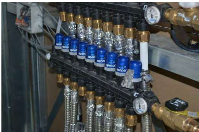
Instalația de distribuție a panourilor radiante
